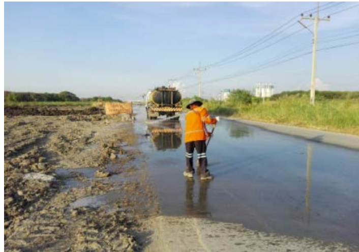
ฉีดน้ำพื้นที่ถนน บริเวณรถบรรทุกดินโครงการวิ่งผ่าน เพื่อลดฝุ่นละออง
